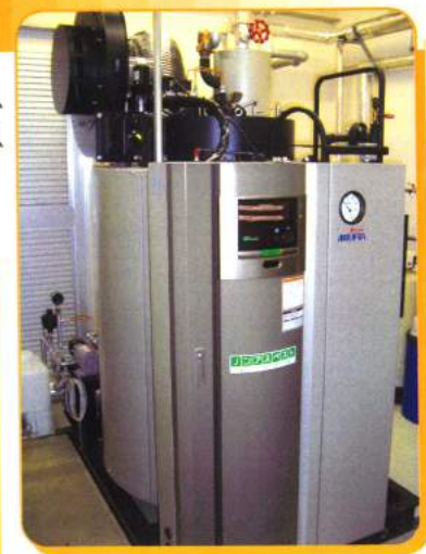
1トンボイラ 5%効率が上がりました
